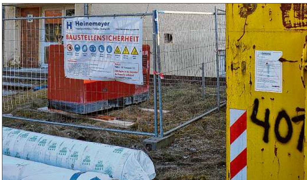
Sicherheit geht vor: Solange alte Dämmungen mit krebserregenden Stoffen ausgebaut werden, dürfen die Innenräume nur mit entsprechendem Atemschutz betreten werden.
